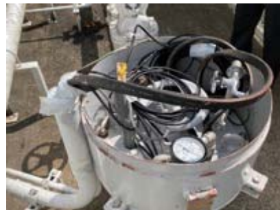
写真 2：北部構内の地下水井戸 (2021 年 5 月 10 日筆者撮影)。
